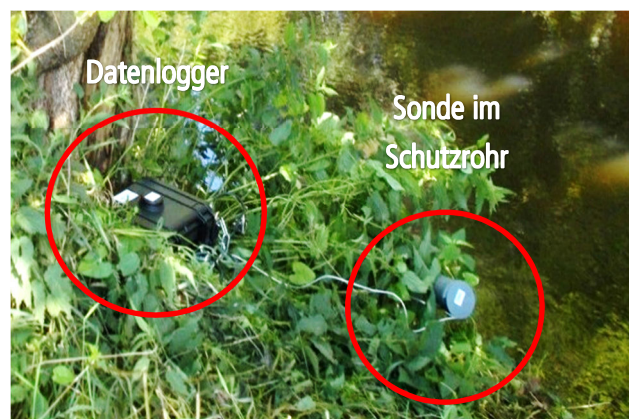
Bild 3: Einbau von EXO 1 und ecoTech enviLog Mobil oberhalb der Kläranlageneinleitung. Der enviLog Mobil ist befestigt und versteckt platziert. Die Sonde ist im Plastikrohr vor Treibgut und Vandalismus geschützt. Quelle: Lukas, LLUR
